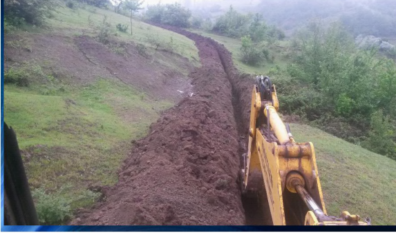
İçme Suyu Boru Hattı
